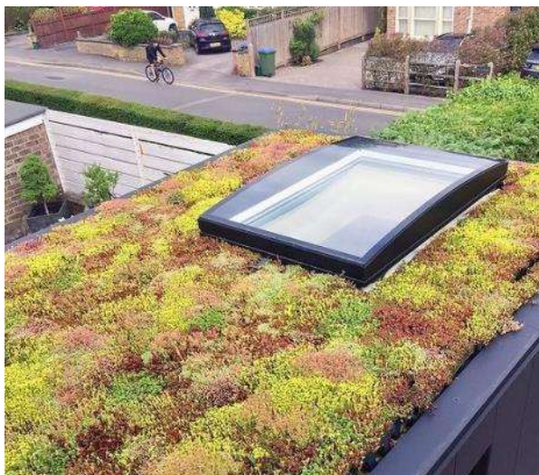
Abbildung 80: Extensive Dachbegrünung (Quelle: Optigrün)
