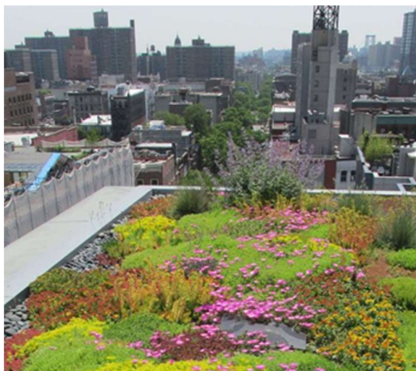
Abbildung 81: Extensive Dachbegrünung (Quelle: Optigrün)
